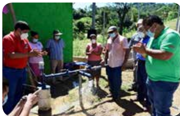
Sistema de agua potable funcionando en Jutiapa.
