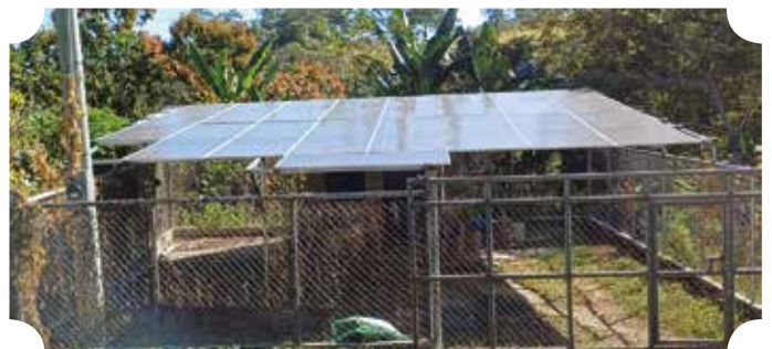
Foto 8: Sistema fotovoltaico en sistema de agua potable.
