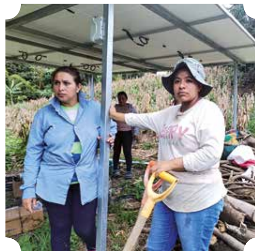
Foto 4. Sistema fotovoltaico San Ramón.
